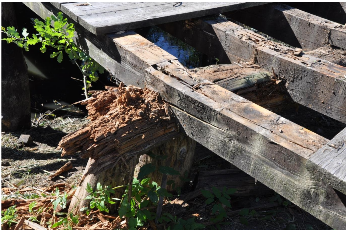
Całkowicie uszkodzona podwalina – złącze z palem spróchniałe, widoczna degradacja górnej płaszczyzny elementu
