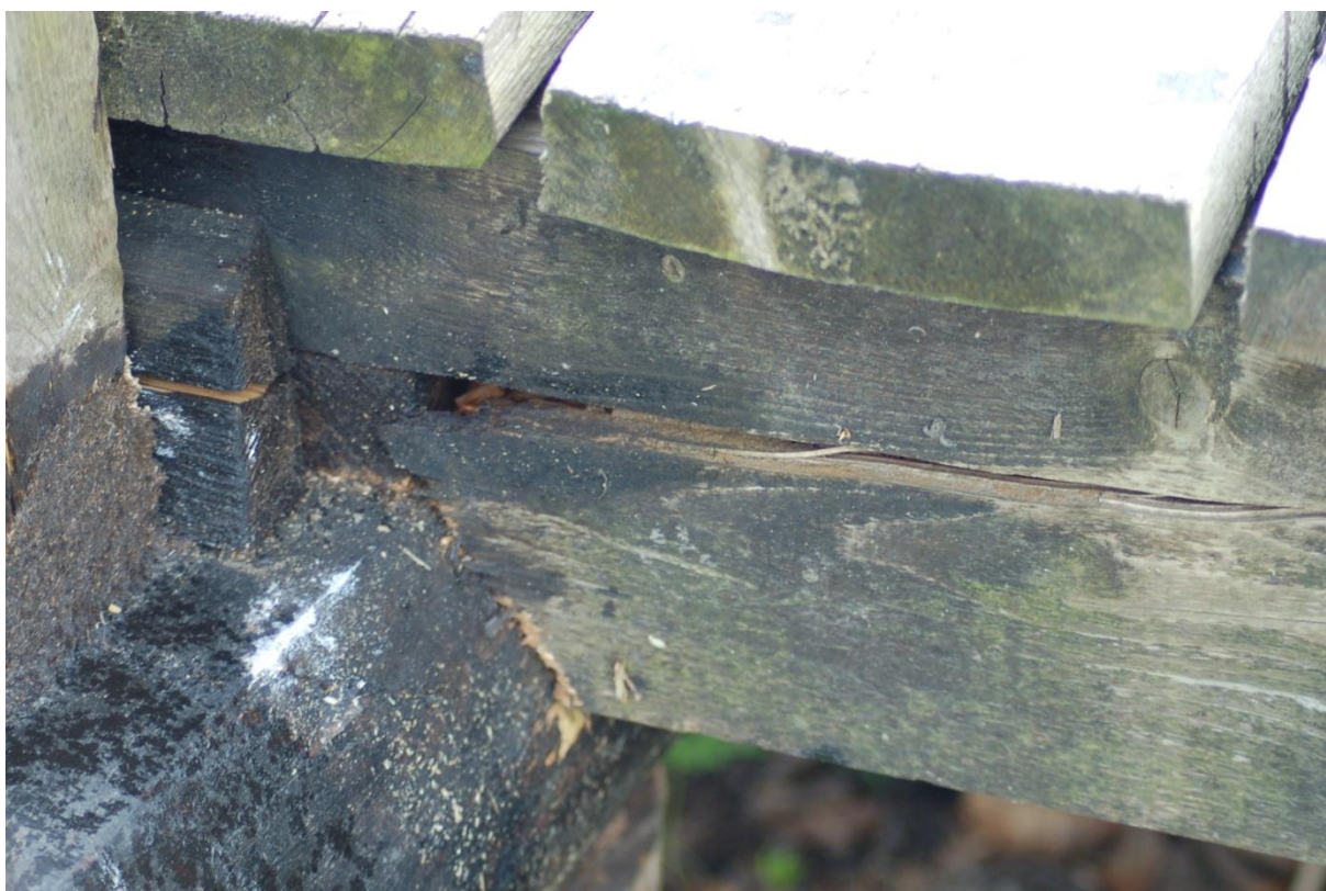
Głęboki zacios spowodował rozwarstwienie podłużnicy wzdłuż włókien
