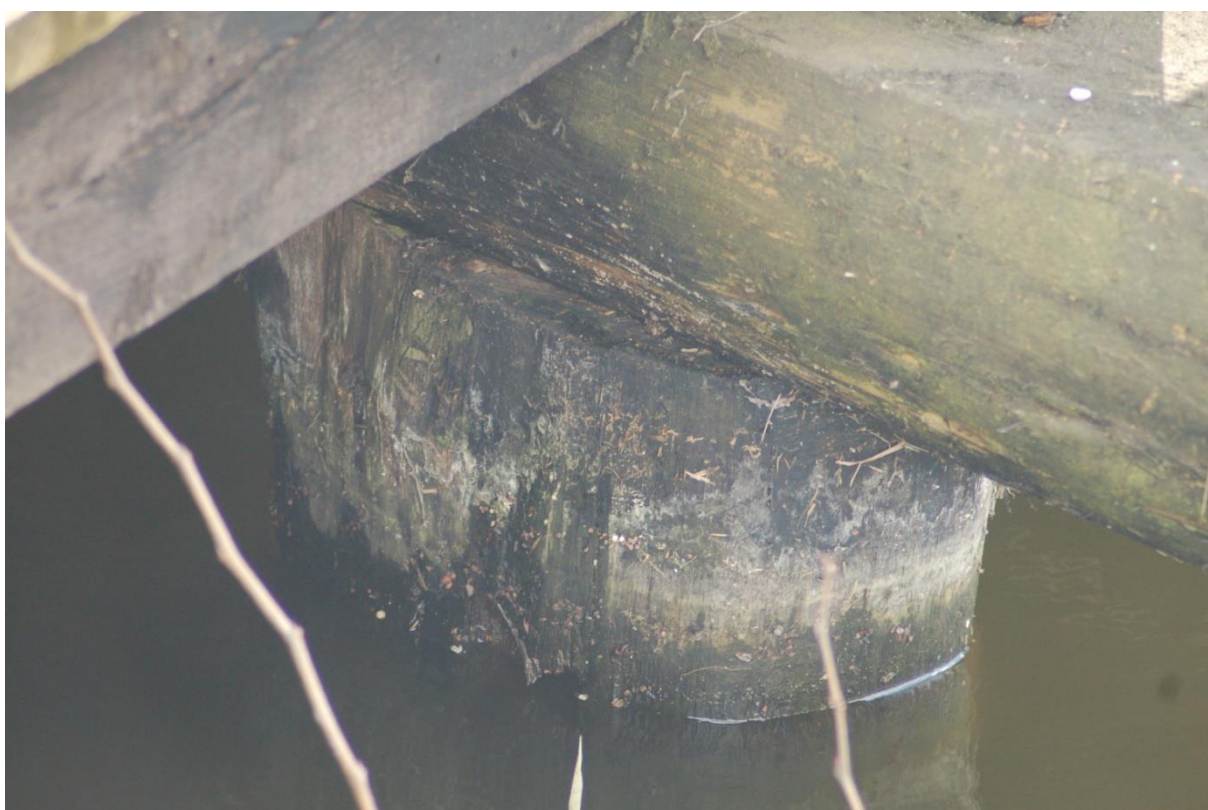
Krótki pal o zawilgoconej głowicy uszkadza spoczywającą na nim podwalinę – ciągłe zawilgocenie powoduje rozwój biologicznych szkodników drewna.
