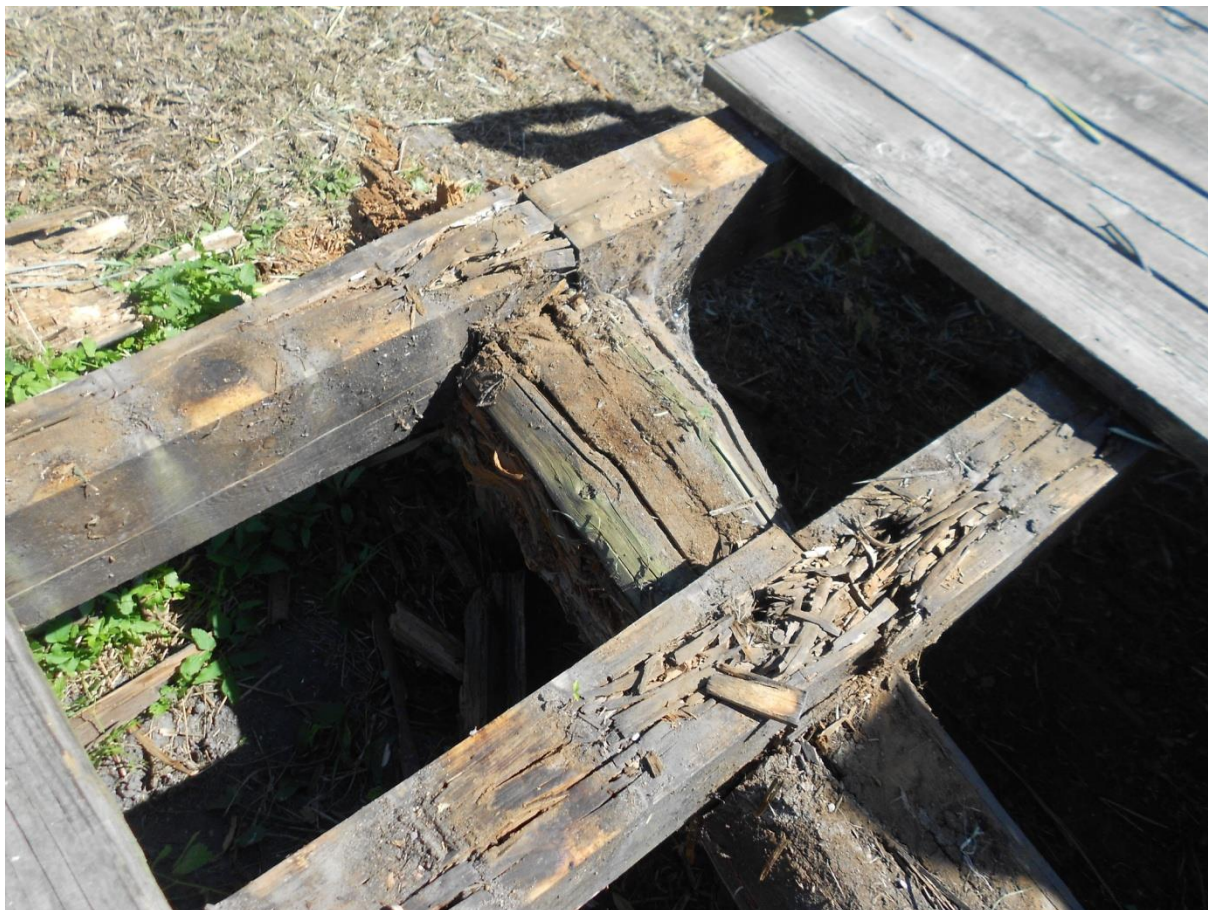
Próchnica atakująca elementy nośne – widoczne głębokie zaciosy na połączeniach elementów nośnych, które osłabiają przekrój drewna.
