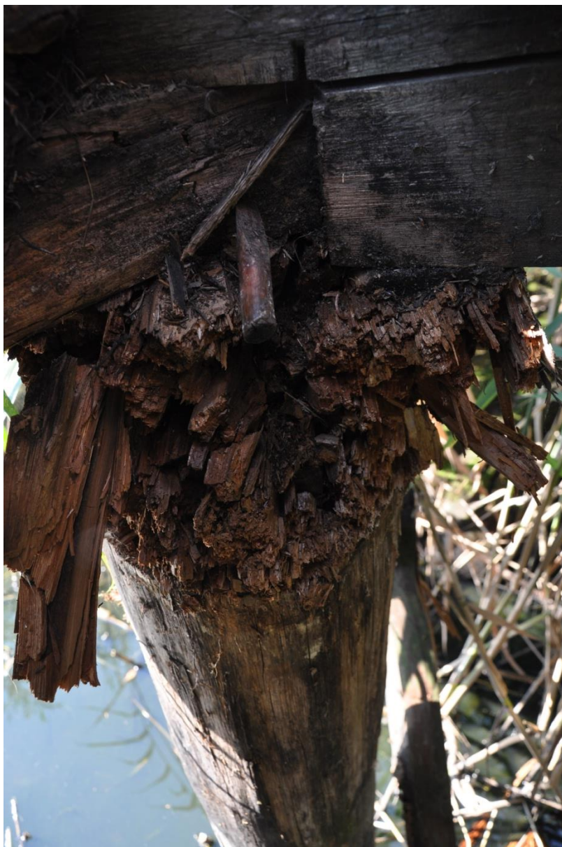
Pal z całkowicie spróchniałą głowicą – stan z lata 2016 roku – po lokalnej rozbiórce pomostu z desek i belek nośnych.
