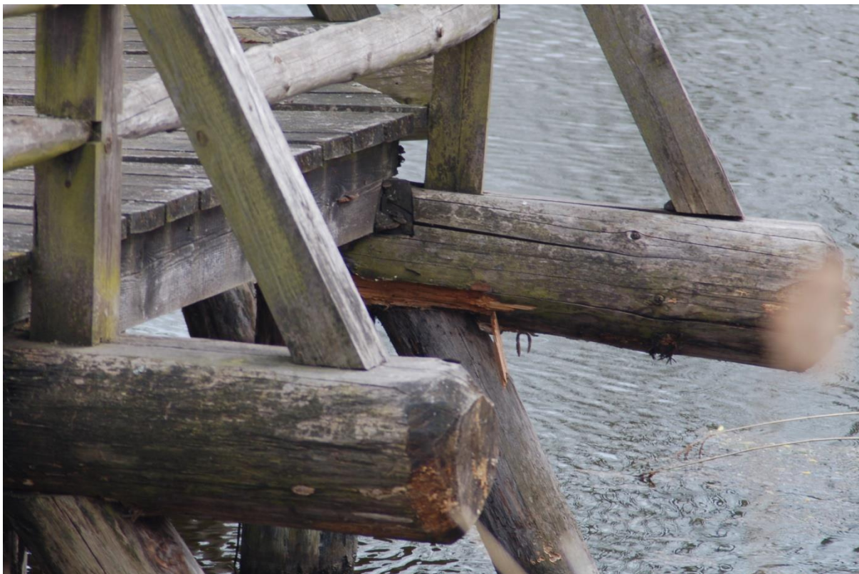
Ubytki w miejscu połączenia dalszej podwaliny z palem nosnym.
