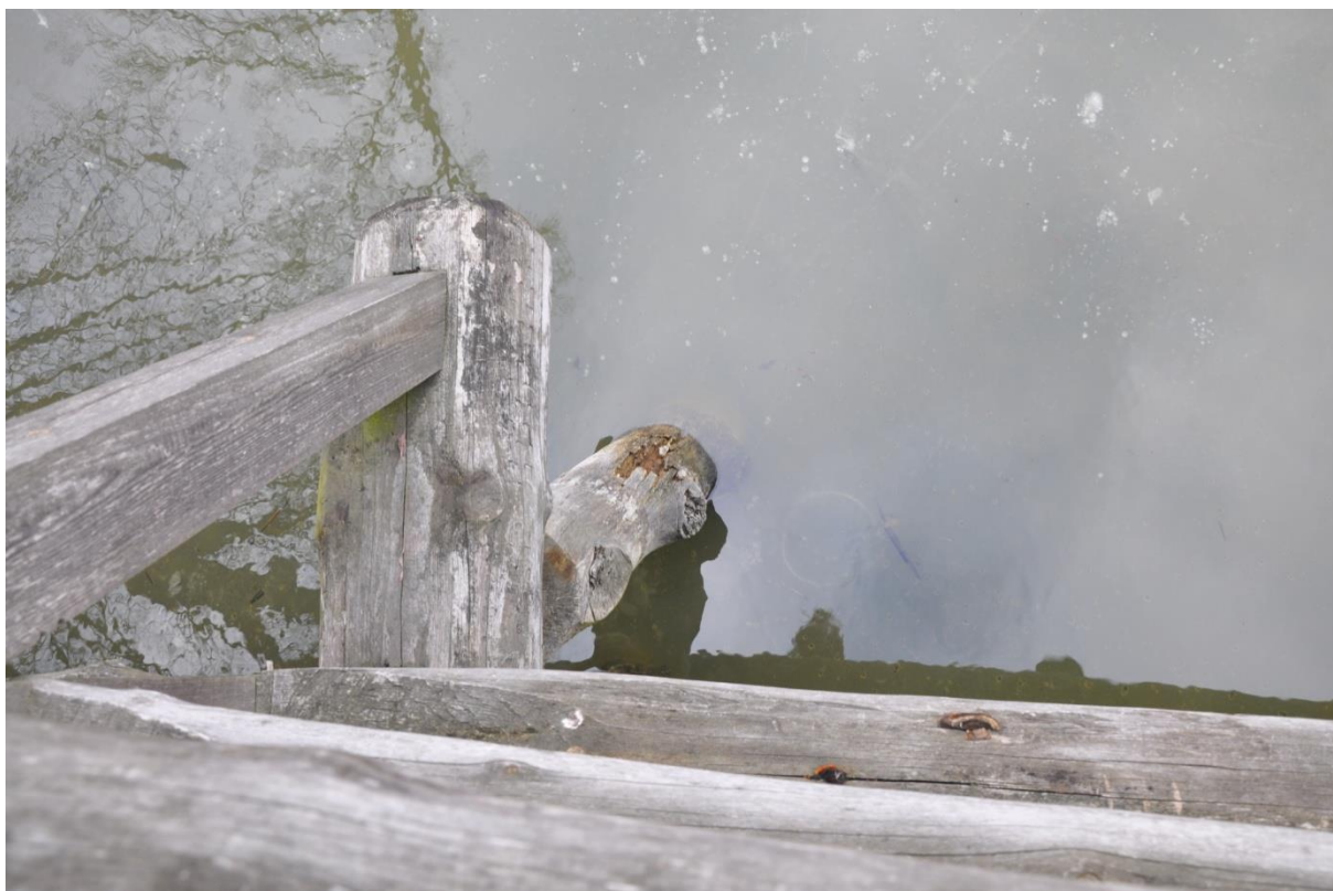
Pal skośny z wżerem powyżej lustra wody
