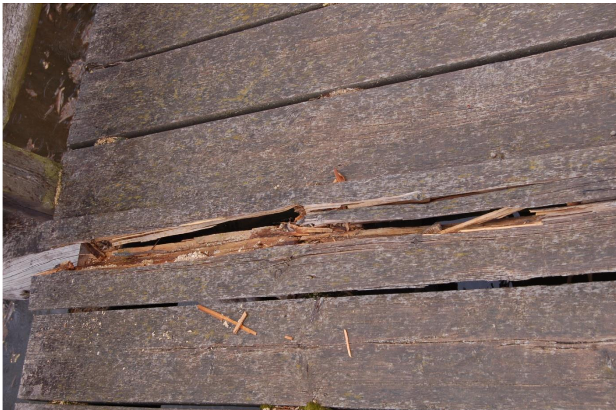
Uszkodzona deska pokładu.
