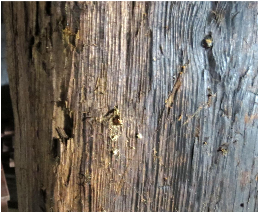
Miejsce dokonania nawiertu w łątce (słupie)
